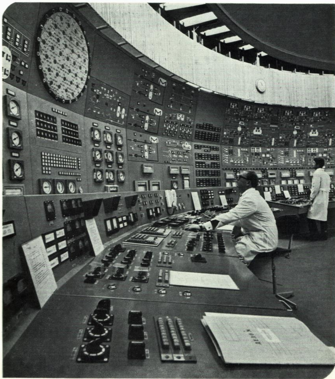
Пульт управления Кольской АЭС.
